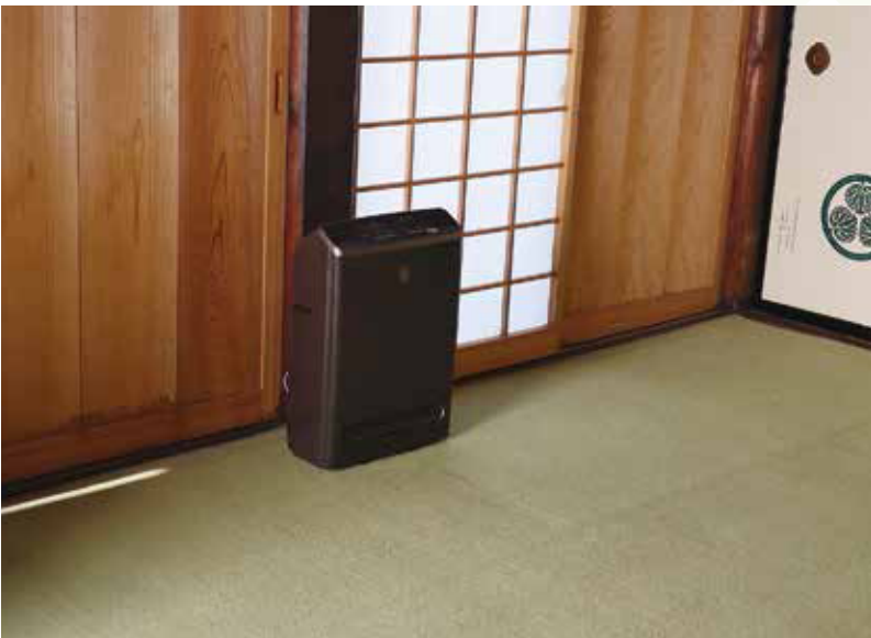
本堂に設置した空気清浄機
